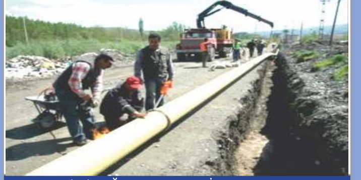
ANADOLU (66) DAĞINIK SH ALT YAPI İNŞAATI
